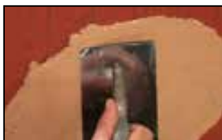
Étape 1 - application directe sur brique plâtrée légèrement humidifiée (pas de sous couche de fond ou d'accroche)
